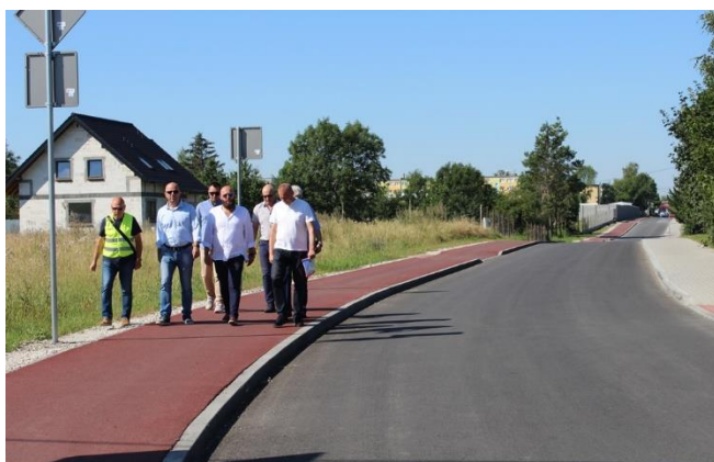
Ulica Wspólna po przebudowie – w ramach zadania: Przebudowa ulic Pięknej, Kwiatowej i Wspólnej
